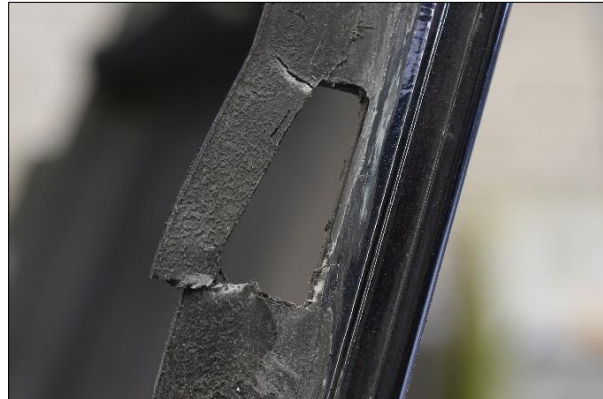
Abbildung 17: Bruch des instandgesetzten Kunststoffstegs ohne Klammer
