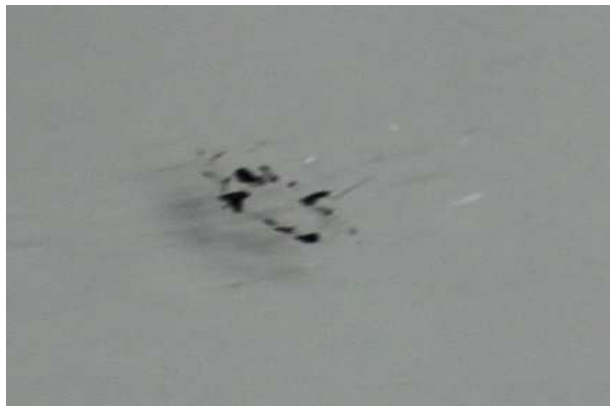
Bild 4: nicht fachgerecht instandgesetzt/ Lufteinschlüsse vorhanden
