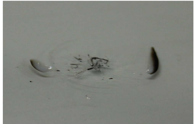
Bild 6: nicht fachgerecht instandgesetzt/ Lufteinschlüsse vorhanden
